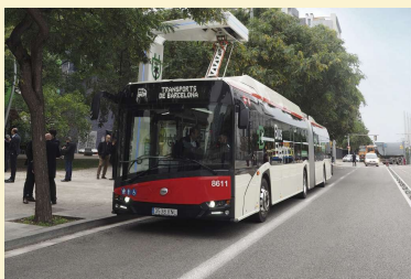
Nabíjecí infrastruktura na autobusové zastávce
