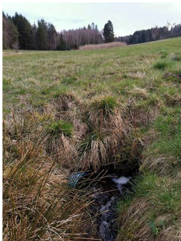
Abbildung 12 Tier2_MuehlbacherWaldung_02.jpg - Drainageauslass im unteren Wiesenbereich.
